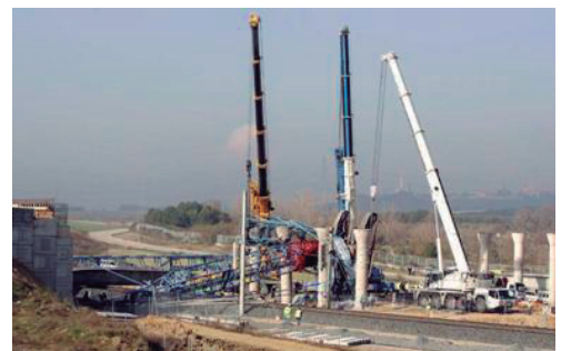
VIGA SOSTENIDA POR GRÚA QUE CAYÓ SOBRE CATENARIA FERROVIARIA DEL COMITENTE
