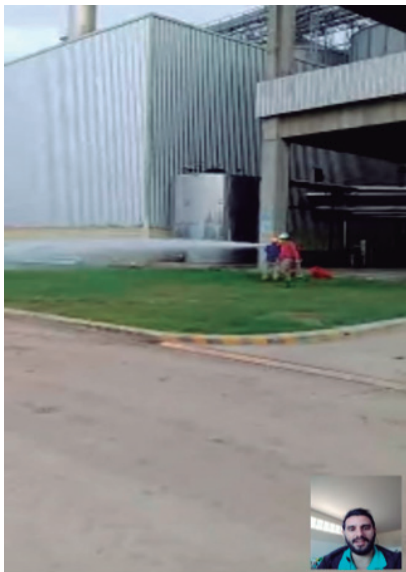
PRUEBA DEL SISTEMA DE AGUA DE INSTALACIÓN CONTRA INCENDIO EN VIVO DE FORMA REMOTA
