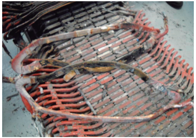
ESTA IMAGEN MUESTRA DOS BOBINAS DE LA ZONA DE LA REPARACIÓN ANTERIOR CON AISLACIÓN MIXTA UNA PARTE EPOXI, Y OTRA BITUMINOSA
