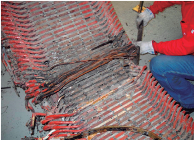
DESMONTANDO BOBINAS PARA SU INSPECCIÓN.
