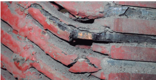
EN ESTA IMAGEN SE OBSERVAN LOS RESTOS DE POLVO COMPACTADO DEBAJO DEL BARNIZ Y ADHERIDOS A LA ANTIGUA AISLACIÓN.
